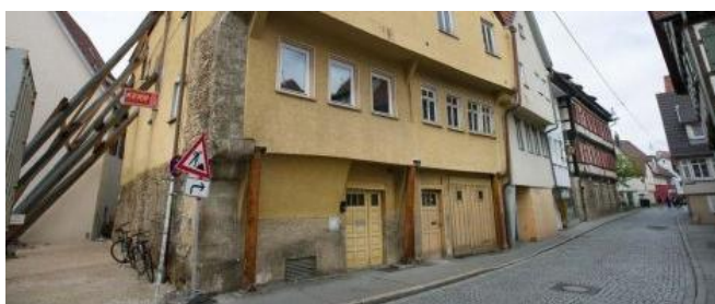
Dringend sanierungsbedürftig: Die Häuser an der Oberamteistraße.
