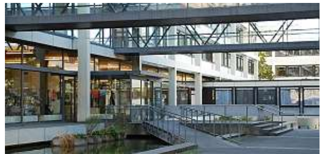
Das Reutlinger Rathaus ist in die Jahre gekommen und muss grundlegend saniert werden.
